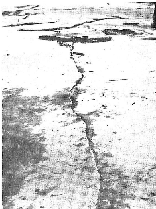
Sl. 9 — Pukotine asfaltno-betske konstrukcije transportnog puta izazvane mrazno-dinamičkim pojavama.
