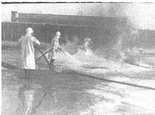
Sl. 5 — Vatra u bazenima je završena. Abb. 5 — Das Feuer in Behältern ist erstickt.
