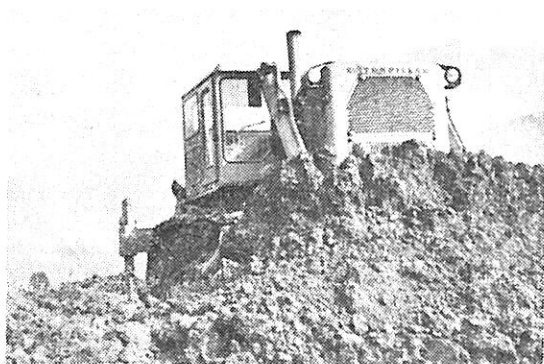
Sl. 2 — Vlastita težina buldozera i prizme materijala izaziva dopunsko opterećenje na rubu trupa odlagališta
