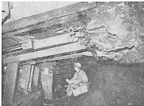
Sl. 3 — Primena štitova sistema KTU-2M kod dobivanja uglja iz stropa na rudniku Velenje.
