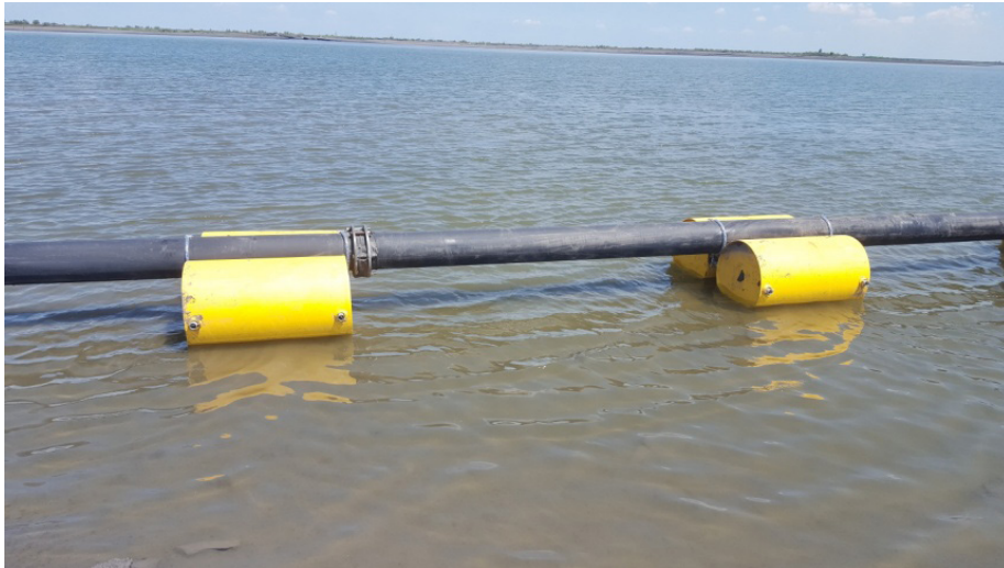
Слика / Figure 2, Цевовод на понтонским ослоњцима / Pipeline on the pontoon supports
